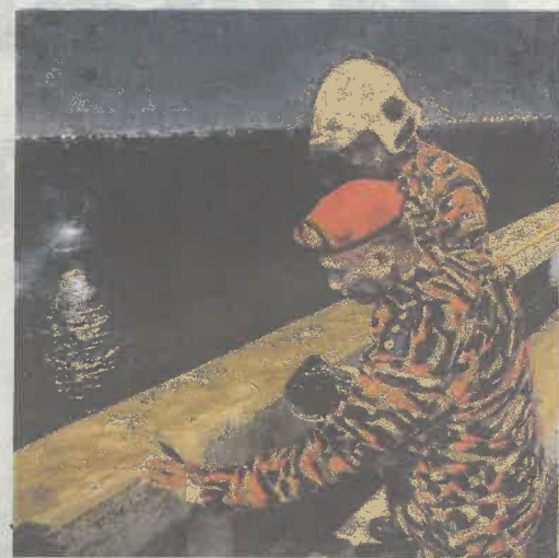
Bomba memeriksa kesan pada tembok jambatan.
